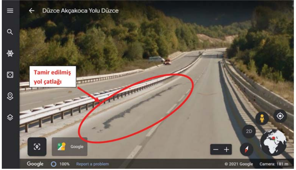
Şekil 14 - Göçen bölgede tamir edilmiş olan yol çatlakları (Kaynak: Google Earth)
