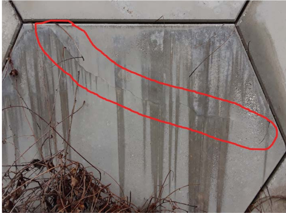
Şekil 10 - Prekast cephe elemanında görülen çapraz çatlak
