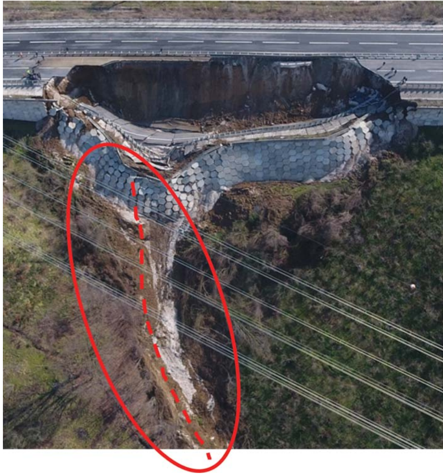
Şekil 12 - Göçen bölgenin karşıdan görünümü ve duvar önündeki su yolu
