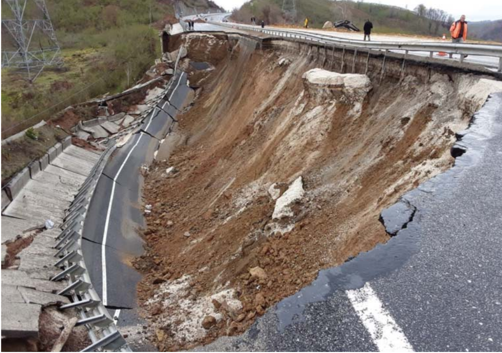
Şekil 11b - Göçme bölgesi genel görünümü
