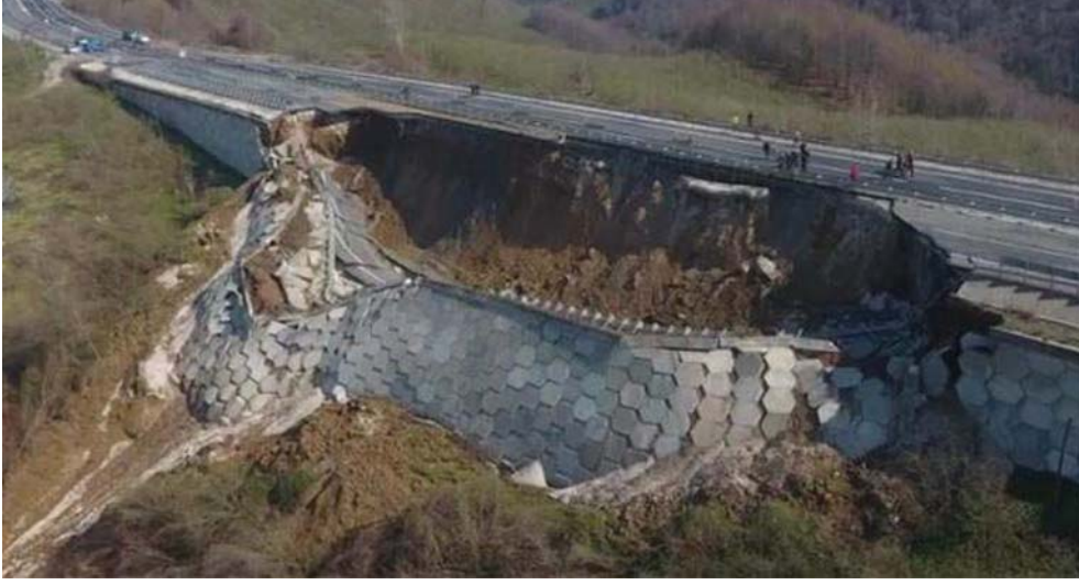
Şekil 11a - Göçme bölgesi genel görünümü
